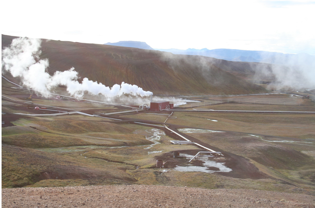
Mynd 16 Safnæðalagnir frá borholum á borsvæðum að skiljustöð og lokahúsi við Kröflustöð.
